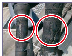
塩害による 高圧ケーブルの劣化
