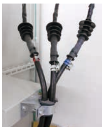
高圧ケーブル (キュービクル内)
