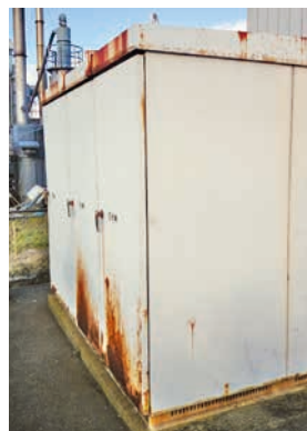
サビが発生したキュービクル
