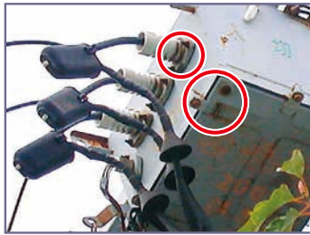
開閉器外観不良(サビ)
