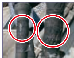
塩害による 高圧ケーブルの劣化
