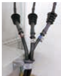
高圧ケーブル (キュービクル内)
