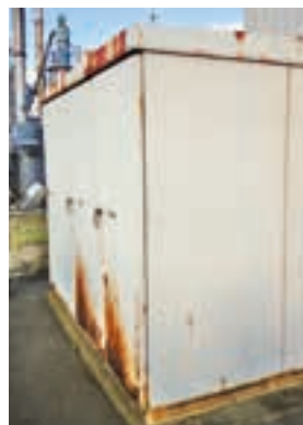
サビが発生したキュービクル
