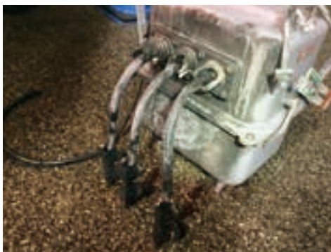
強風雪により接続点が短絡した屋外高圧負荷開閉器
