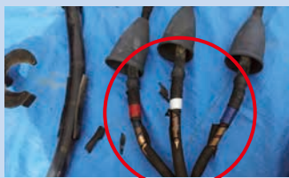
電柱側の高圧ケーブル端末処理部分
