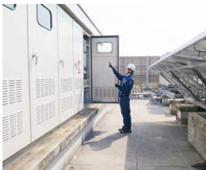
受電設備の点検
