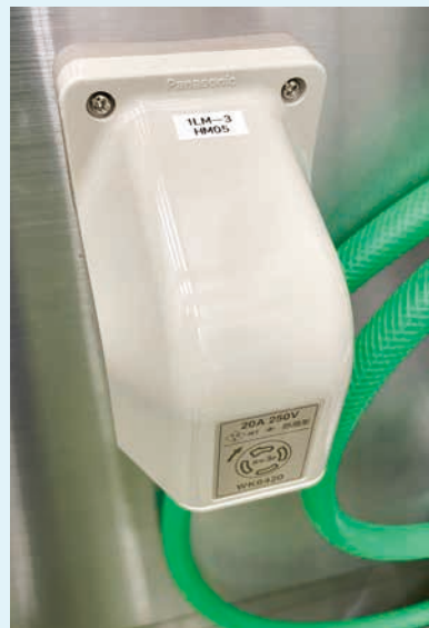
取替後のコンセント
