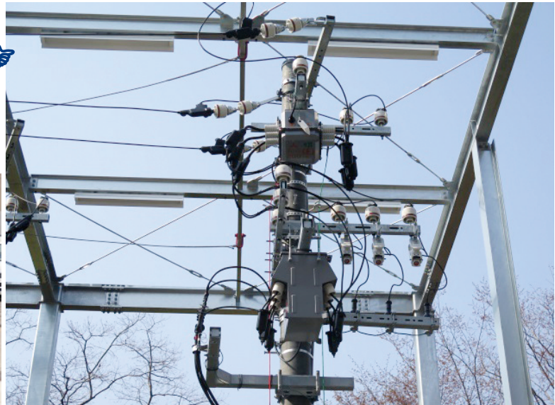
構内柱上部の高圧機器
