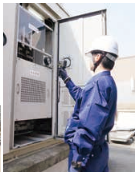
高圧機器の温度を測定 過熱はないか
