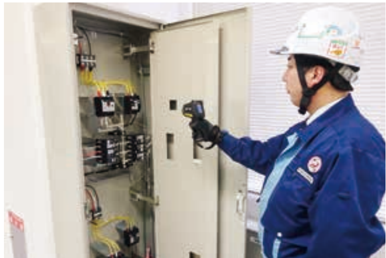
構内の点検 機器・分電盤に異常がないか巡視
