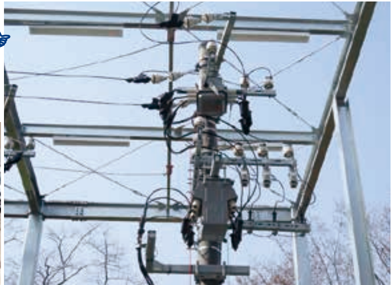
構内柱上部の高圧機器
