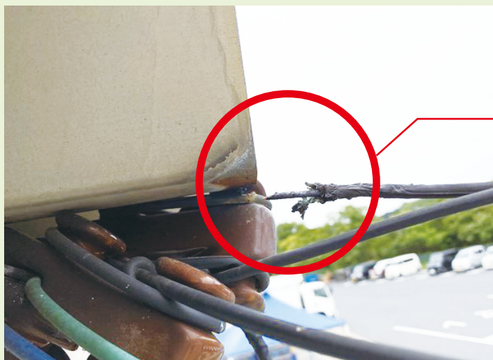
被覆損傷箇所
