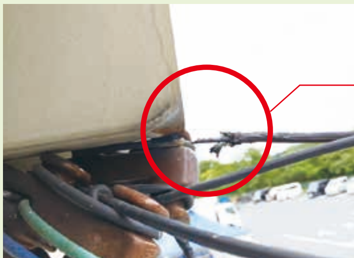
被覆損傷箇所
