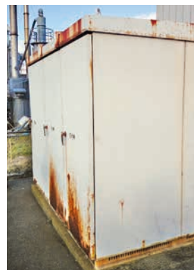
サビが発生したキュービクル
