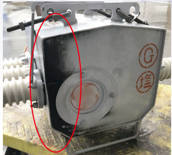
破損したPGS(柱上高圧交流ガス負荷開閉器)
