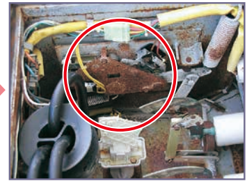
自動開放装置の動作不能 (高圧漏電保護が働かない)
