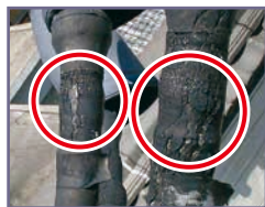
塩害による 高圧ケーブルの劣化
