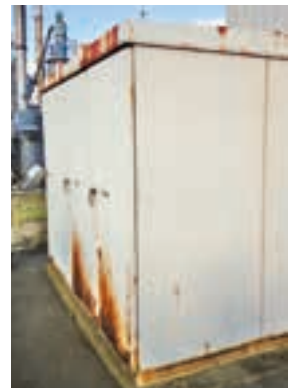
サビが発生したキュービクル
