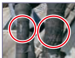
塩害による 高圧ケーブルの劣化
