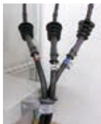
高圧ケーブル (キュービクル内)
