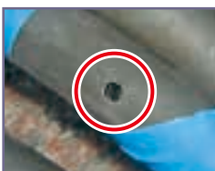
水トリーが原因による 高圧ケーブルの劣化
