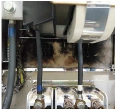
受電盤内損傷状況
