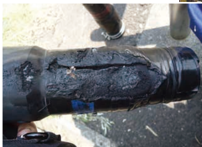
絶縁破壊により焼損した高圧ケーブル
