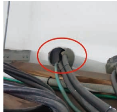
小動物の侵入部: 受配電室の通線口パテ剥落
