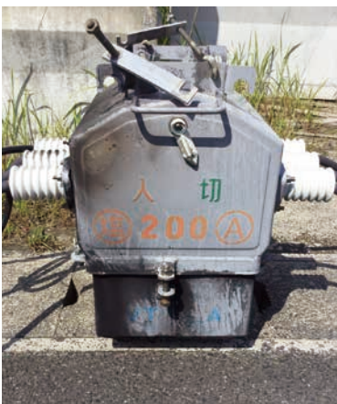
落雷により焼損した屋外高圧負荷開閉器
