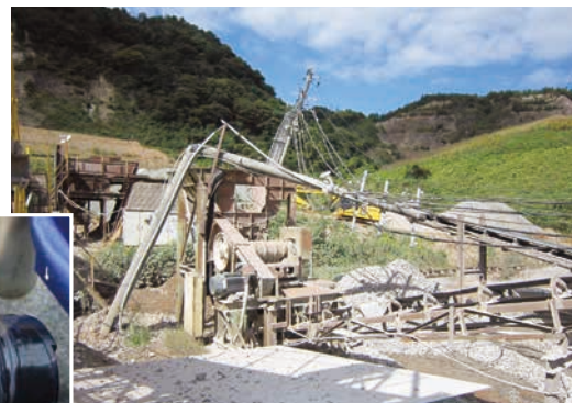
ショベルカーによる構内電柱倒壊事故
