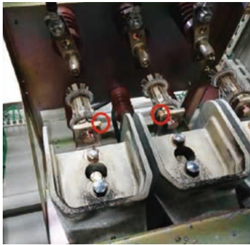
事故点: 真空遮断器R-S相 溶解痕あり
