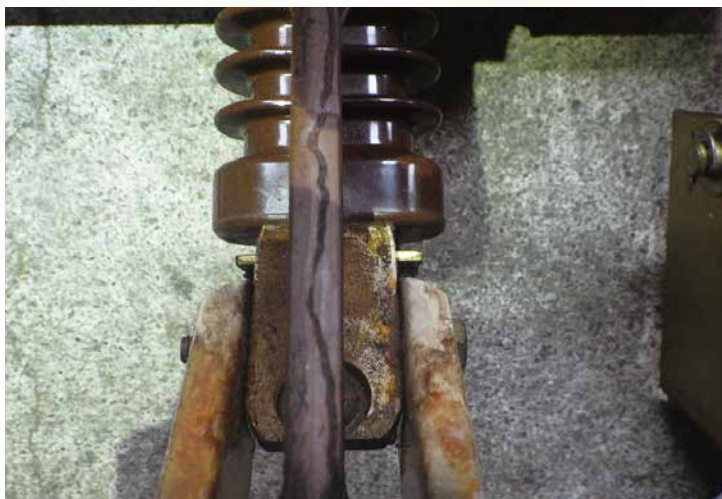
事故点:受電断路器(DS) 操作ロッドのトラッキング状況
