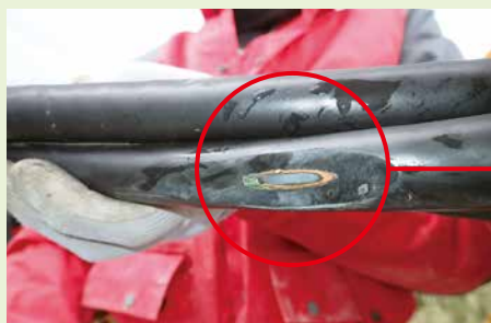
ケーブル 損傷箇所
