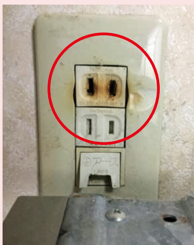
過熱して変色したコンセント
