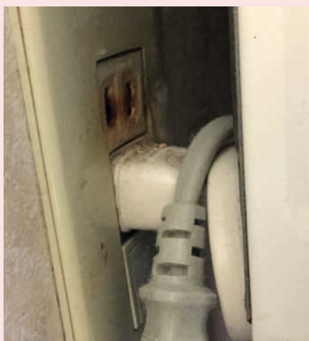
乾燥機本体でコンセントが隠れていた
