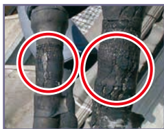
塩害による 高压ケーブルの劣化
