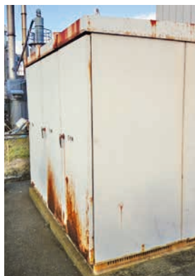
サビが発生したキュービクル
