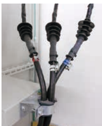
高压ケーブル (キュービクル内)
