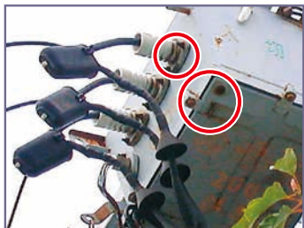
開閉器外観不良(サビ)
