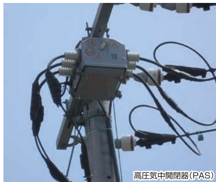
高压気中開閉器(PAS)
