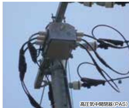
高压気中開閉器(PAS)
