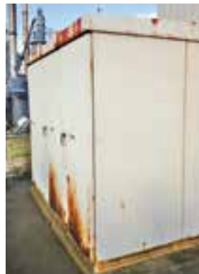
サビが発生したキュービクル
