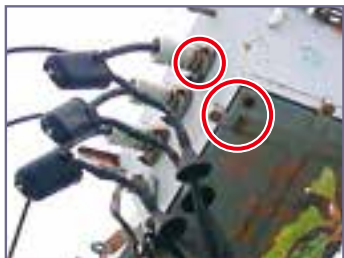
開閉器外観不良(サビ)
