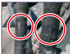
塩害による 高压ケーブルの劣化
