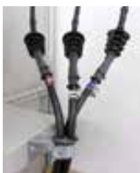
高压ケーブル (キュービクル内)
