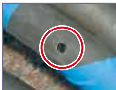
水トリが原因による 高压ケーブルの劣化
