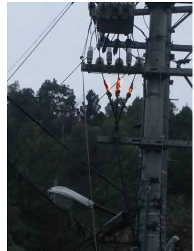
経年劣化で焼損したケーブル
