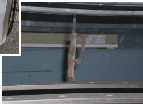
小動物の侵入で高圧地絡事故
