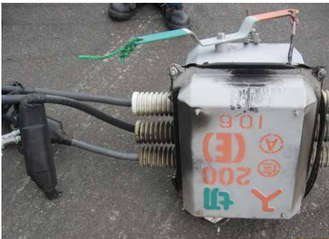
雷により焼損した屋外高圧負荷開閉器
