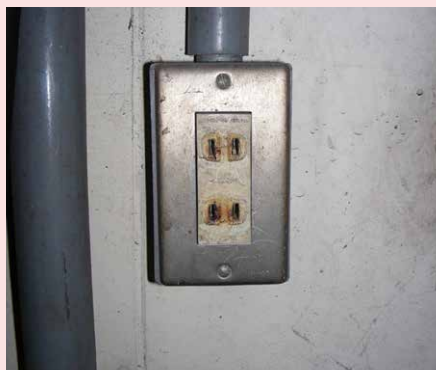
58℃を表示した工場内コンセント
