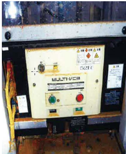
豪雨により水没した真空遮断器
