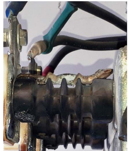
小動物(ヤモリ)の侵入で地絡事故となった負荷開閉器
