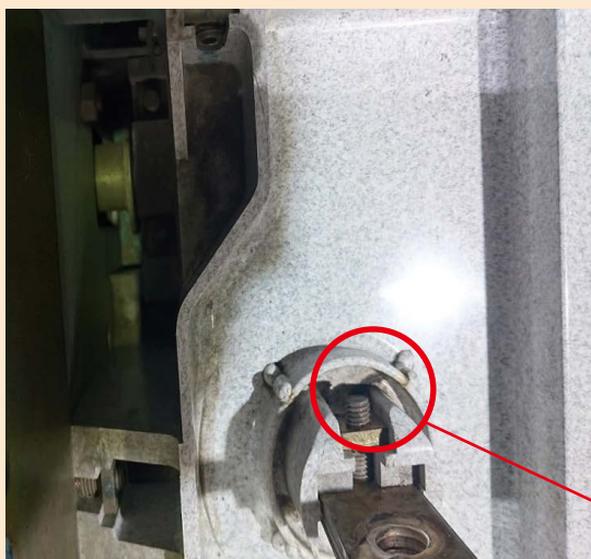
写真1 高圧遮断器(VCB)
