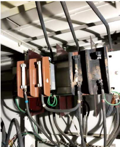
雷により焼損した計器用変圧器
