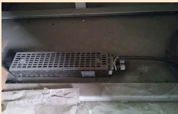
写真2 結露防止用のスペースヒーター
