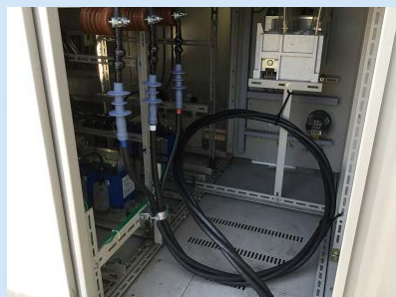
高圧ケーブルのピンホール部分
