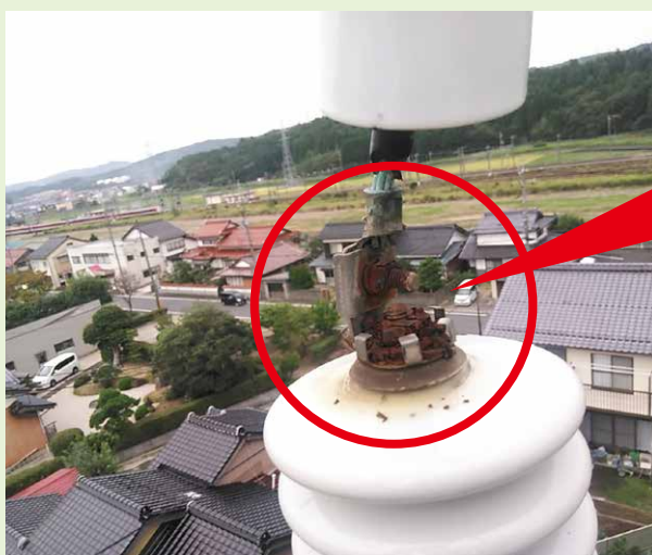
避雷器端子部 サビによる腐食
