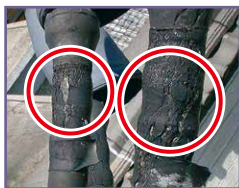
塩害による 高压ケーブルの劣化
