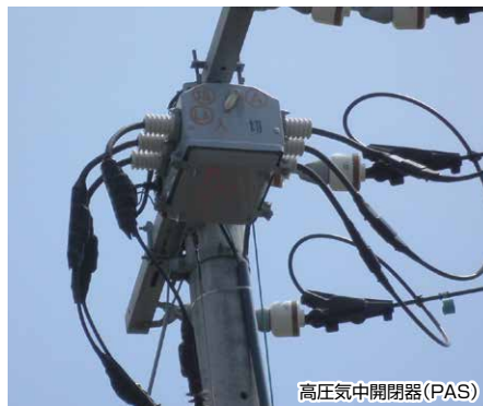
高压気中開閉器(PAS)
