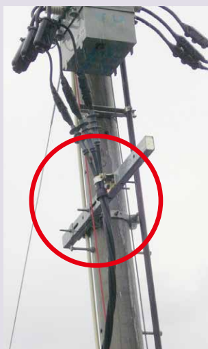
ケーブル支持が脱落した状態
