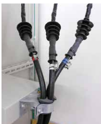
高压ケーブル (キュービクル内)
