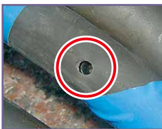
水トリーが原因による 高压ケーブルの劣化
