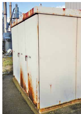
サビが発生したキュービクル
