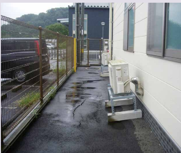
地盤沈下により傾いた空調器の室外機 地盤沈下した位置が高圧ケーブルの埋設経路
