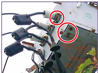
開閉器外観不良(サビ)
