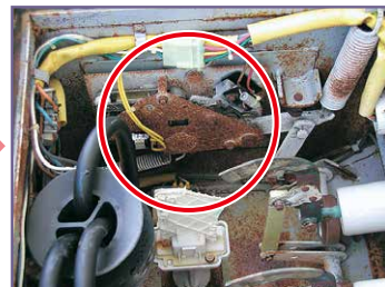
自動開放装置の動作不能 (高压漏電保護が働かない)
