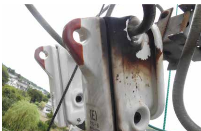
ガラスが接触し焼損した柱上のカットアウト
