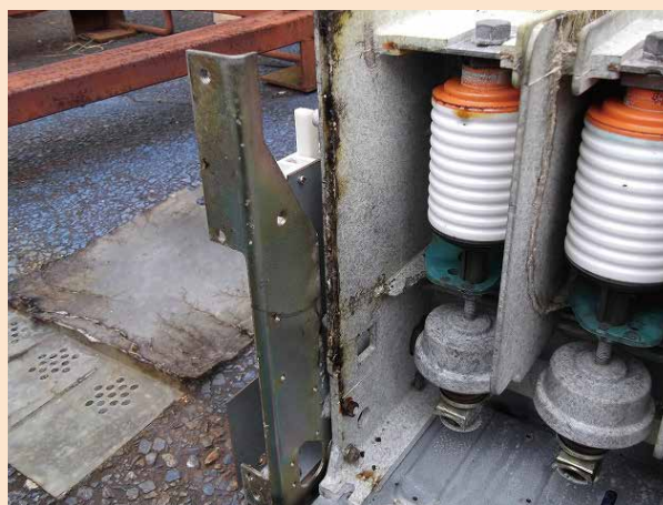
真空遮断器裏面本体部分
