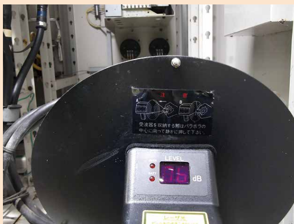
測定器(ウルトラホン)による部分放電測定
