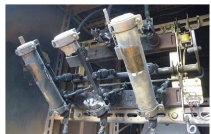
機器の内部短絡により破裂したヒューズ
