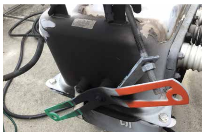
雷により焼損した高圧開閉器
