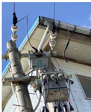
雷害により焼損した高圧負荷開閉器
