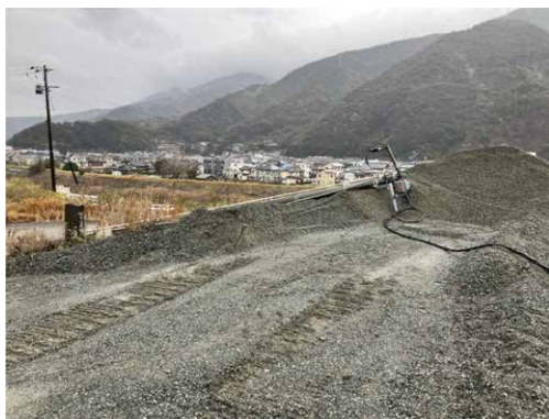
作業者の過失により重機が接触して倒壊した構内柱
