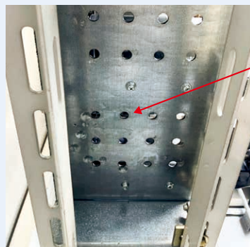
低圧コンデンサ（LCユニット）の底面の穴から漏油を確認
