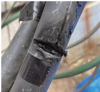
作業者の過失により切断された高圧ケーブル
