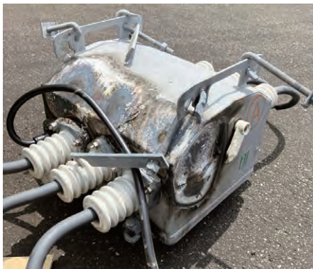
雷害により焼損した高圧負荷開閉器
